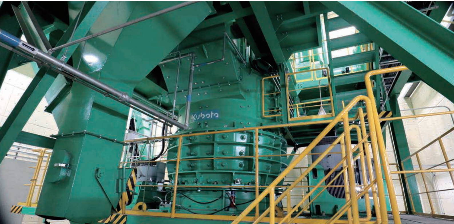
完成した縦型破碎機、中央の円柱部分で破碎が行われます
