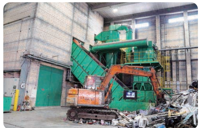
重機で粗大ごみをコンベアに投入し、破碎機で細かく粉碎します
