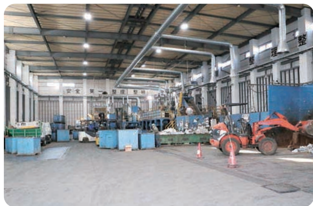
不燃ごみの選別プラント
